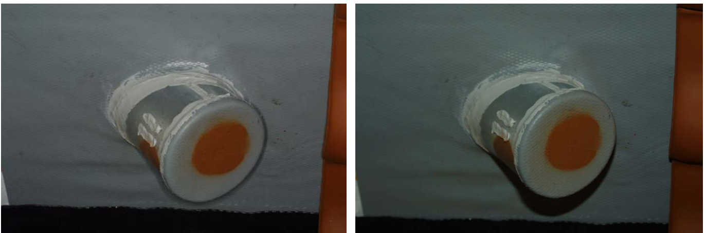
Figur 4. Prøveemne med gennemføringsselement udført i galvaniseret plade før (til venstre) og efter (til højre) påvirkning i By og Bygs klimasimulator.
